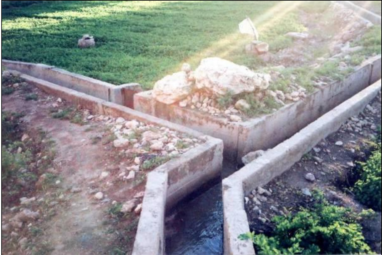
Photo 4 : Seguias véhiculant les eaux usées brutes
